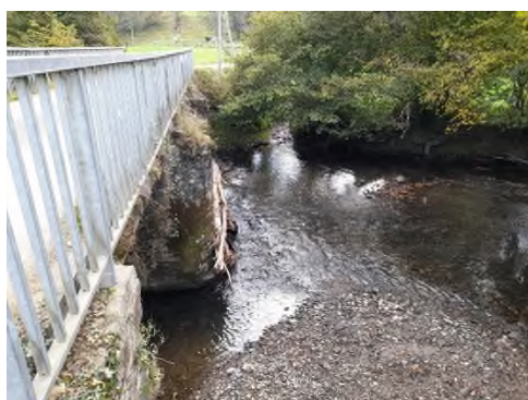
Embâcle sur ouvrage (Beez)
