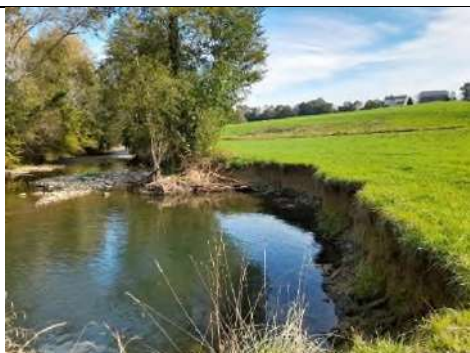
Intervention non prévu sur des secteurs sans enjeu (intervention privilégiée sur l'ouvrage responsable de cette érosion aval)
